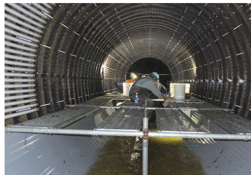
大口径管路内に人力で専用部材を設置 して更生するフローリング工法
