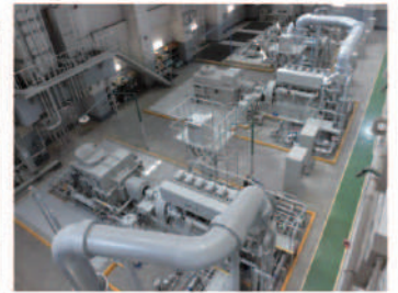
雨の降り方や戸田川の水位に応じて排水機能を発揮する5つのポンプを設置
